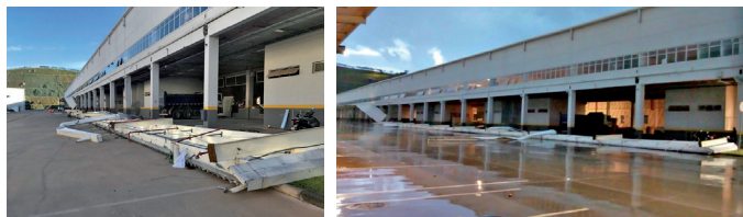
Fotos 1 e 2. Marquise em Centro de Distribuição, Itapevi
